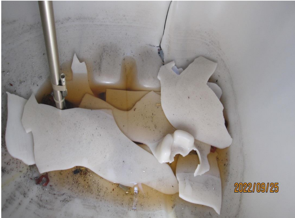
Зураг 20. Түлшний савны эвдрэл
