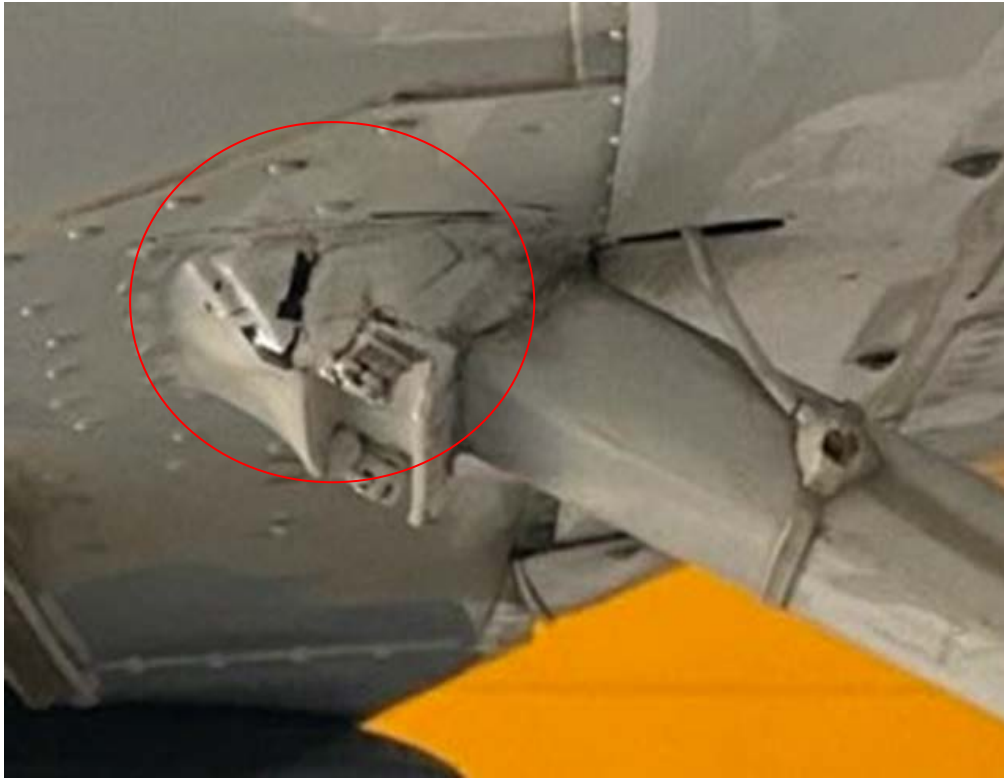
Зураг 12. Баруун үндсэн хөл ангийн өөхий доорх бэхэлгээний хэсгийн гаднах селекон болон будагтай хэсэг нь доргилтоос үүдэлтэй гэмтэж хагарсан байдал /хойд талаас нь/
